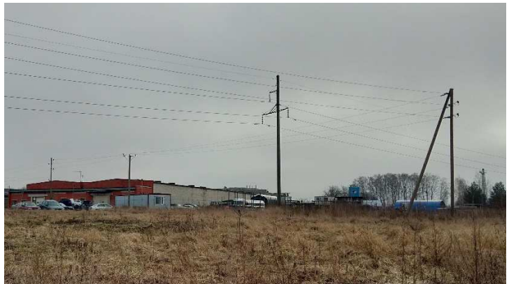
11.attēls. Skats no neapbūvētas teritorijas uz 110kV un 20kV elektrolīnijām.
